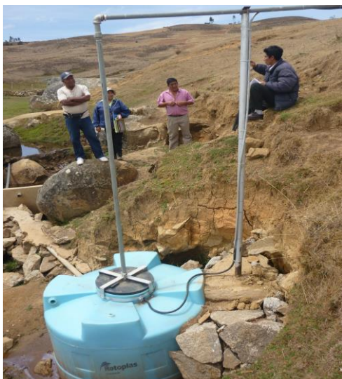
Foto N° 2. Pozas de captación de agua de uso doméstico en caserío Alto Poclús del cual se bombea a un reservorio usando paneles foto voltaicos
